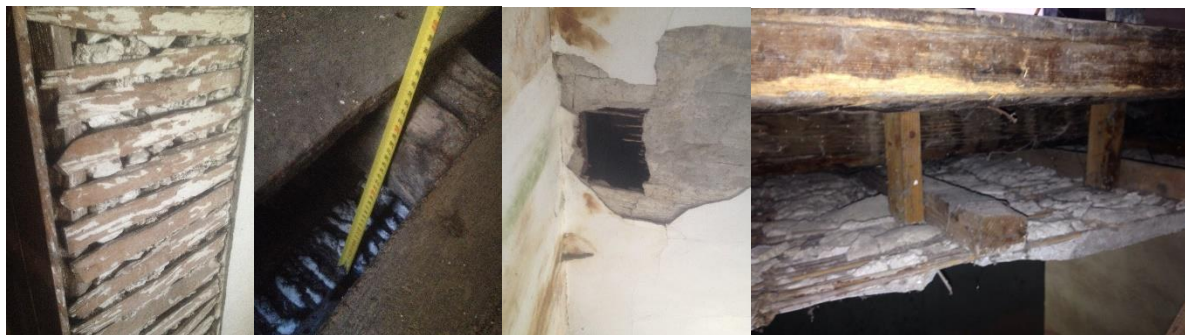
Figura 89. A. Detaj muri ndarës realizuar me strukturë druri; B. Dimensionimi i soletës së drurit; C. Detaj mbyllje tavanit me kallama+teli +suva; D. Prej tavanit prej druri (Banesat historike; burimi: K. Xhexhi)
