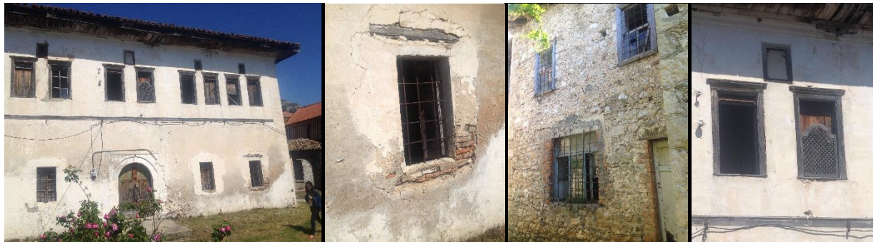
Figura 92. A. Hyrja e banesës; B. Detaj dritare + arkitra druri+ tullë e kuqe. C. Implementimi i tullave të kuqe në strukturën e muraturës; D. Detaj dritare kati i parë + çarje për ventilim (Banesat historike, burimi: K. Xhexhi).
